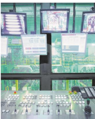
Контроль и автоматизация
